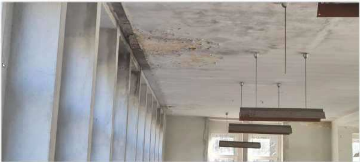
Detalj propuštanja-curenje vode s plafona
