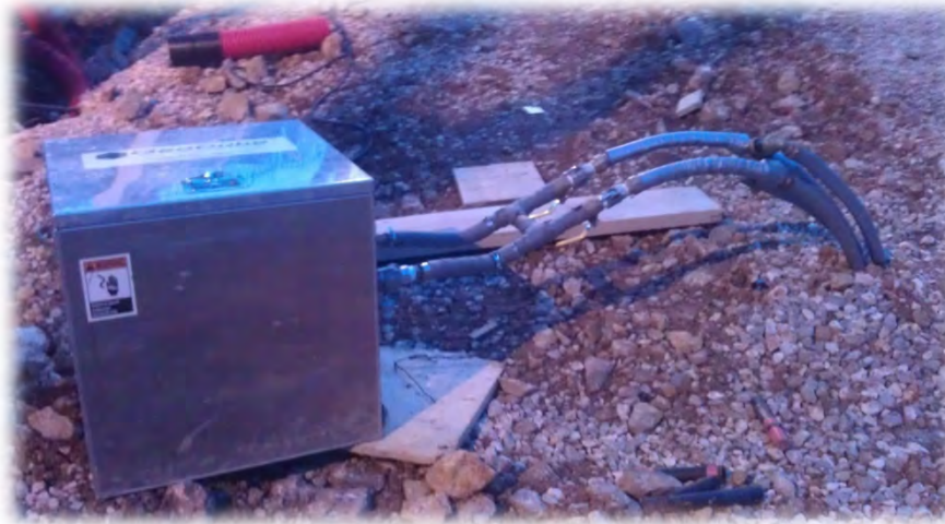
9. Rijeka – 2 bušotinska izmjenjivača – obiteljska kuća - 2014
