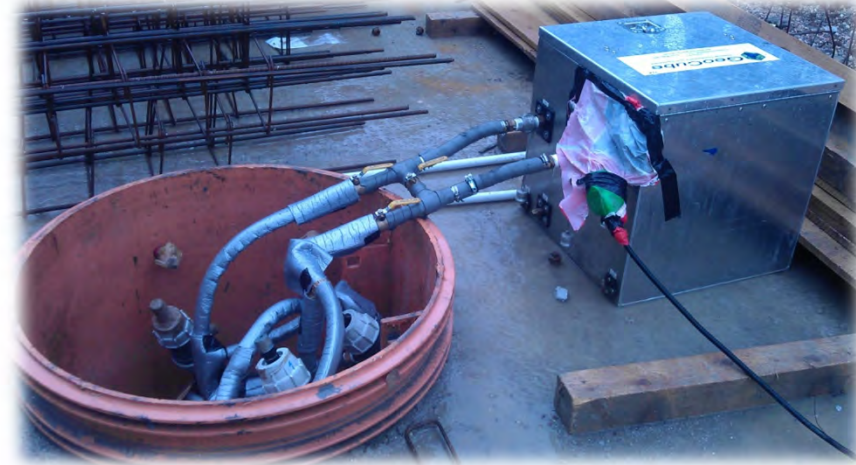
10. Rijeka – 12 koaksijalnih bušotinskih izmjenjivača – obiteljska kuća - 2014
